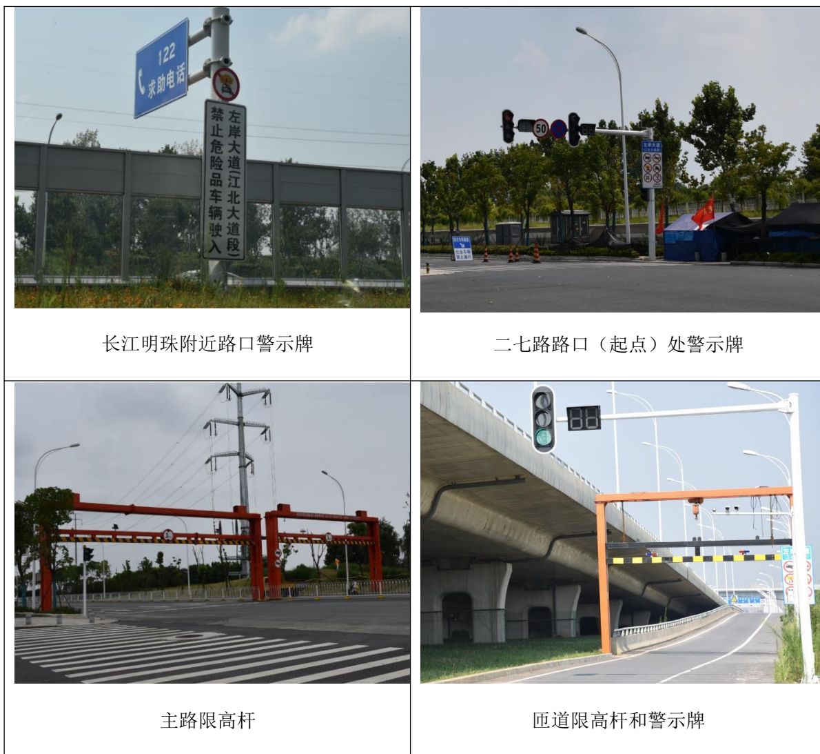
图 8.2-1 道路运营期限高杆和警示牌安装现状
